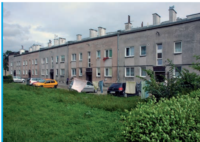
11. Jeden z budynków dawnego osiedla „PAGED” (ul. Tuchomska 5). Elewacje zostały pozbawione pierwotnej okładziny z płytek elewacyjnych (betonowych i klinkierowych) poza fragmentami w partiach wejściowych. Widoczne dwubarwne wymalowanie poszczególnych segmentów (klatek schodowych) jest wynikiem powojennych prac remontowych elewacji budynku. Stan z 2011 r. (fot. A. Orchowska-Smolińska)
