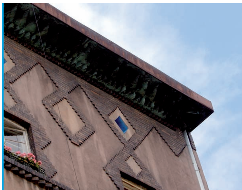
3. Fryz wieńczący budynek ZUPU, ubytki tynku przed remontem konserwatorskim. Stan z roku 2009 (fot. Maria Filipowicz)
