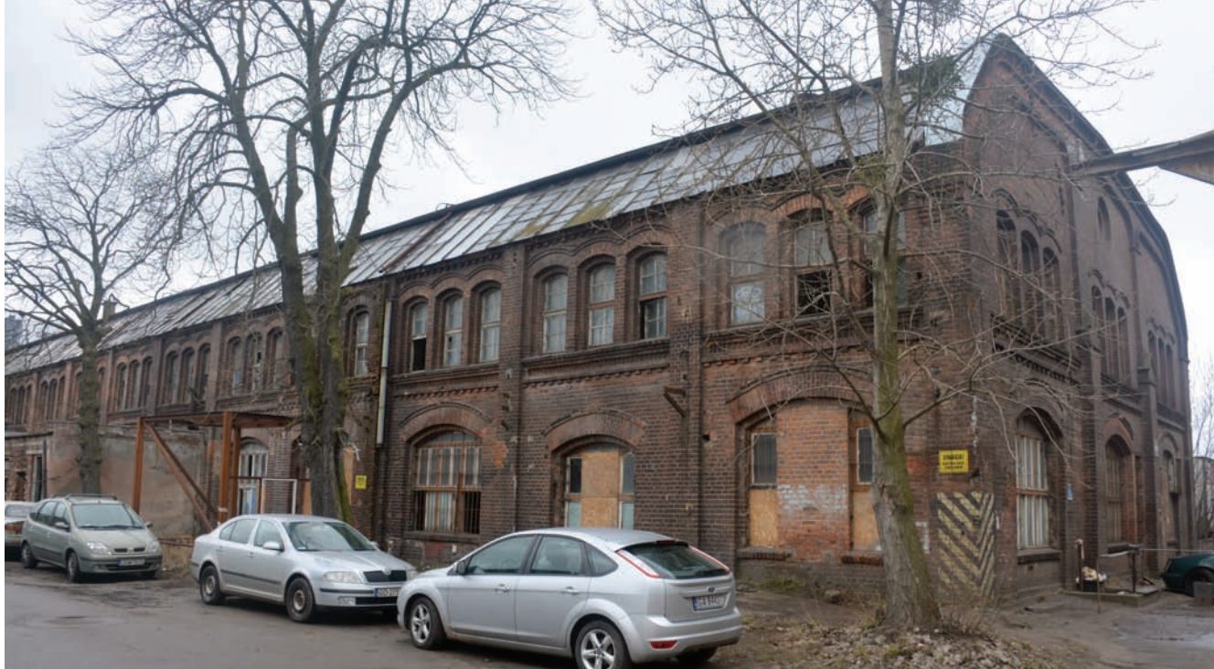
1. Gdańsk, ul. Narzędziowców, budynek hali montażu silników z końca XIX wieku, stan z 2019 r. (fot. P. Gerber, 2019) 1. Gdańsk, Narzędziowców St., engine assembly hall from the end of the 19th century (photo P. Gerber, 2019)
