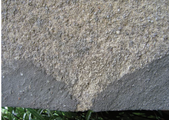
5. Braunlage (Niemcy), Sanatorium Dr. Barnera, Albin Müller 1914. Tynk naturalny żółtawy, porysowany, później odnowiony cementem portlandzkim (fot. Ivo Hammer 2004)
