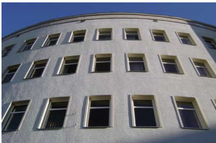
6. Fragment elewacji Sądu Rejonowego Gdyni z tynkiem nakrapianym wykonanym w czasie prac restauratorskich w 2010 r.
