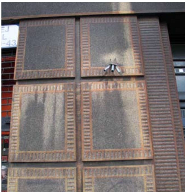
21. Fragment elewacji kamienicy przy ul. Mazowieckiej 26a w Krakowie wykończonej tynkiem kamieniarskim.
