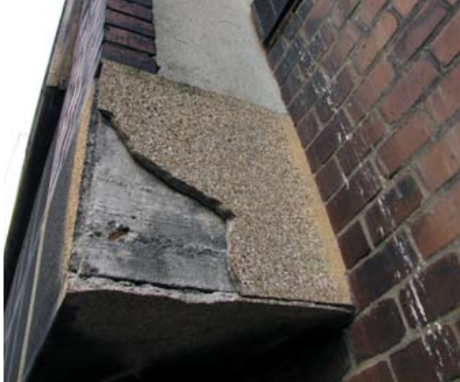
25. Tynk kamieniarski wykonany na żelbetowym wsporniku wykusza kamienicy w Katowicach przy ul. Stalmacha 23
