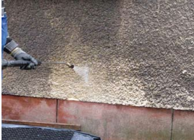
8. Czyszczenie tynku cyklinowanego z lat 30. XX w. odsłania jego pierwotny kolor (budynek przy ul. Bema 5 w Gdyni, 2013 r.)
