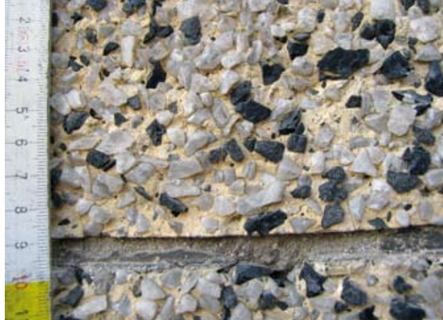
9. Widok faktury tynku zmywanego na elewacji kamienicy przy ul. Świętojańskiej 47 w Gdyni
