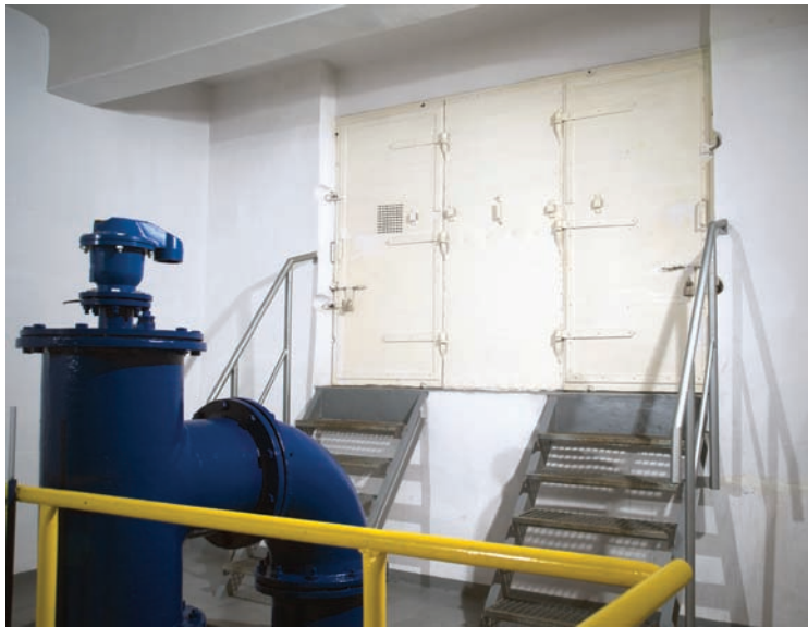
3. Gdynia, zbiornik wody i stacja hydroforowa w okolicy ul. Kwidzińskiej (wnętrze pomieszczenia zasuw), proj. Karol Pomianowski (?), budowa 1929 r., rozbudowa Stanisław Dobiliś 1932 r., (fot. Leszek Żurek, Muzeum Miasta Gdyni, 2021 r.)
