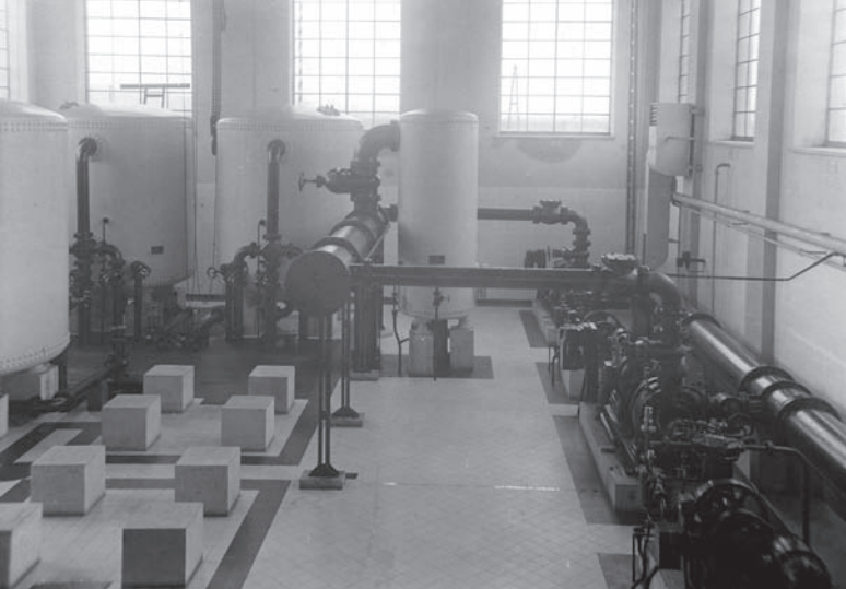
8. Rumia, Główne Ujęcie Wody ZWiK w okolicy ul. Pomorskiej (wnętrze hali maszyn w latach trzydziestych), proj. Jerzy Müller (?), budowa 1933-1934 r., nadbudowa Kazimierz Borkiewicz, 1934 r. (źródło: Muzeum Miasta Gdyni, sygn. MMG/HM/II/521/14, 1934 r.)
