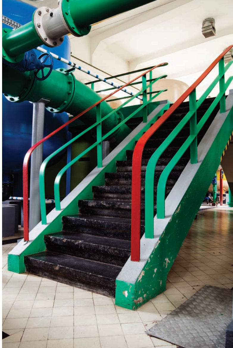
9. Rumia, Główne Ujęcie Wody ZWiK w okolicy ul. Pomorskiej (wnętrze hali maszyn współcześnie), proj. Jerzy Müller (?), budowa 1933-1934 r., nadbudowa Kazimierz Borkiewicz, 1934 r. (fot. Leszek Żurek / Muzeum Miasta Gdyni, 2021 r.)
