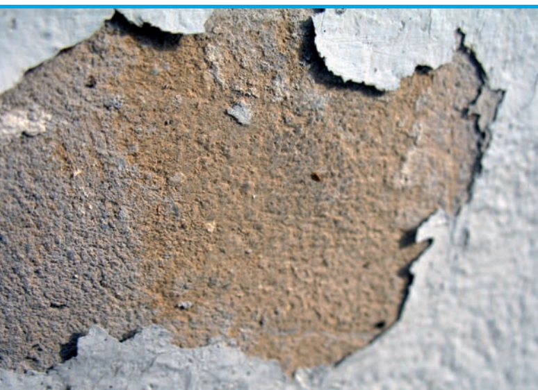
2. Fragment okładziny z piaskowca zamkniętej szczelną powłoką farby. Elewacja dawnego budynku biurowego Bergenske, ul. Portowa 15 (fot. Ewa Jachnicka)
