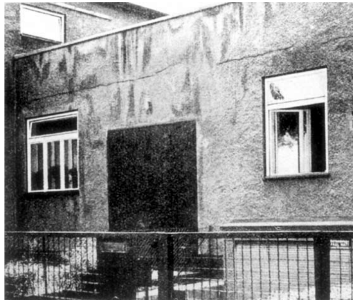
2. Dom nr 26/27, proj Theo Effenberger, stan po 3 latach - pęknięcia poziome, zła konstrukcja stropodachu (O., Ein Spaziergang nach 3 Jahren , „Ostdeutsche Bauzeitung-Breslau”, 1932, s. 299).
