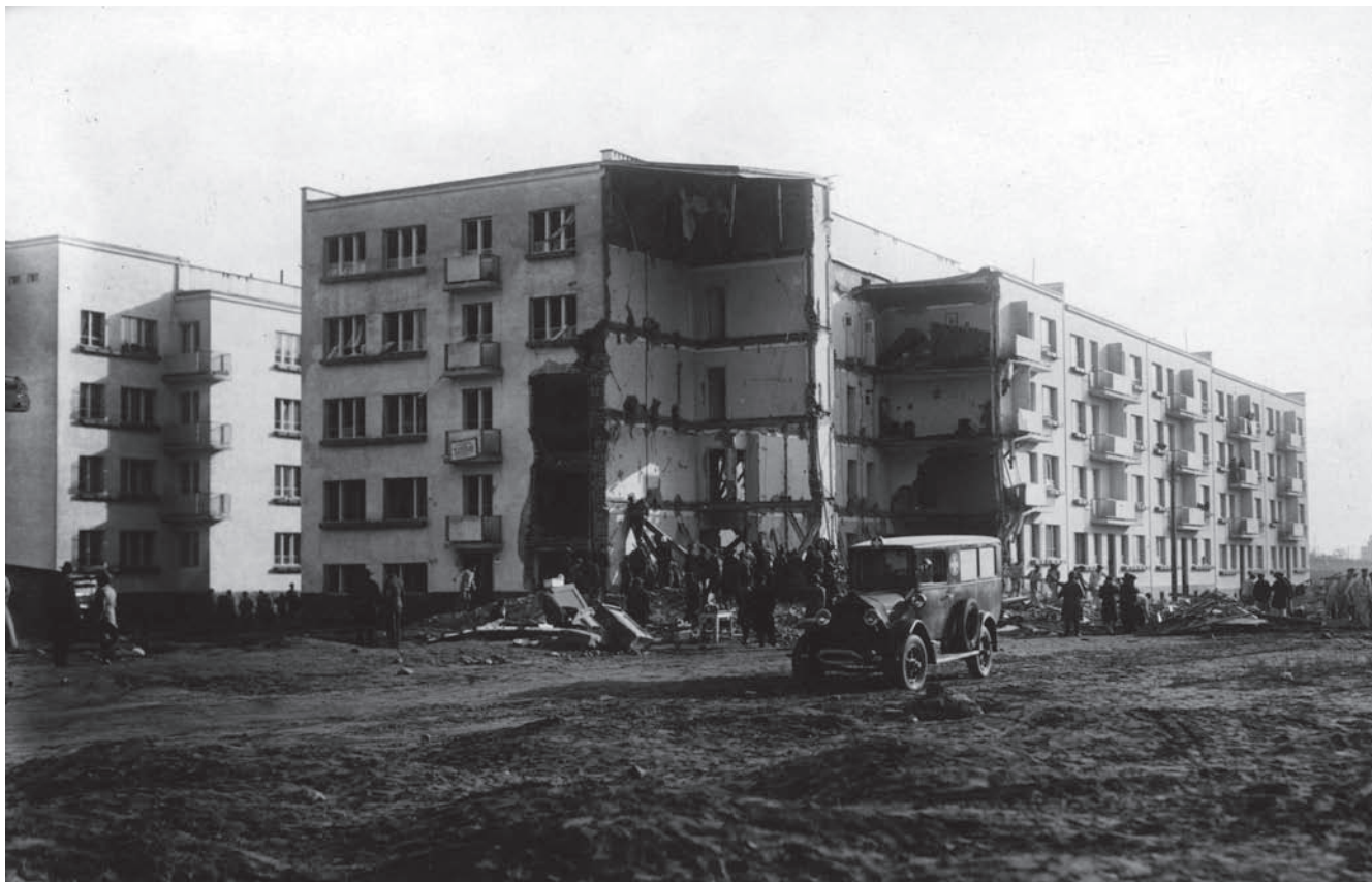
5. Gdynia, al. Marsz. Piłsudskiego 50, budynek mieszkalny ZUPU, stan po wybuchu gazu w październiku 1931 r. (źródło: NAC 3/1/0/8/7230)
