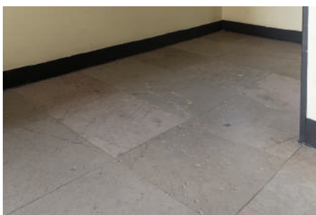
Posadzka w budynku ZUS, ob. Urząd Miasta, przy ul. 10 Lutego 24. Płyty z beżowego i różowego wapienia kieleckiego.
