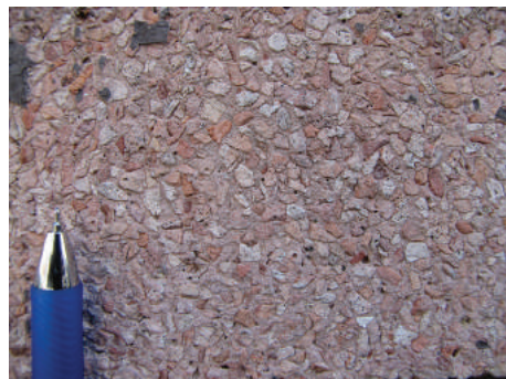
Tynk w kolorze różowym z ziarnami białego i różowego żwirku (w powiększeniu), na elewacji budynku przy ul. Bema.
