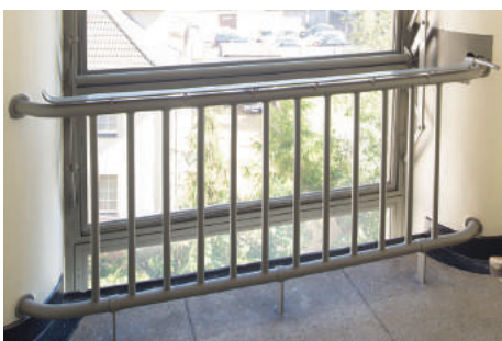
Grzejnik w formie balustrady na klatce schodowej budynku przy ul. 3 Maja 27-31
