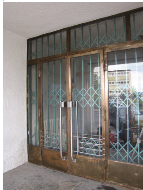
Drzwi bocznego wejścia do Sądu Rejonowego przy placu Konstytucji 5. Jedyne w Gdyni przykłady metalowych drzwi z lat 30. XX w., w których konstrukcja w kolorze mosiądzu została zestawiona z pochwytami z kolorze srebrnym.
