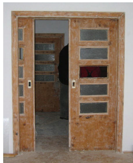
Przesuwne drzwi pomiędzy pokojami w willi w Orłowie, w trakcie prac restauratorskich.
