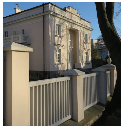
Ogrodzenie willi „Sokola” na Kamiennej Górze z lat 20. XX w. z drewnianymi elementami i murowanymi słupkami na kamiennym cokołe, po odrestaurowaniu.
