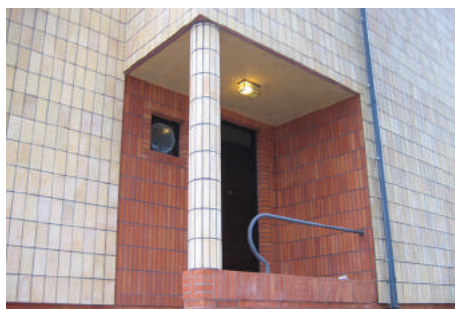
Nowoczesna oprawa oświetleniowa z lat 30. XX w. w formie prostopadłościanu w podcieniu wejściowym do willi w Orłowie
