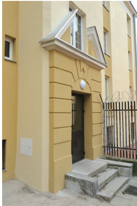
Portal budynku mieszkalnego w dawnym Zespole Dowodztwa Floty na Oksywiu z lat 20. XX w., po konserwacji.
