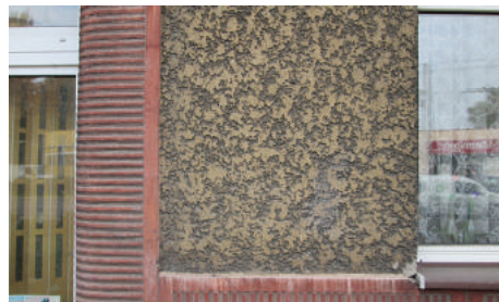
Fragment elewacji budynku przy ul. Chyłońskiej z lat 30. XX w., z dwoma rodzajami tynku – beżowym i czerwonym i różnymi rodzajami dekoracji.
