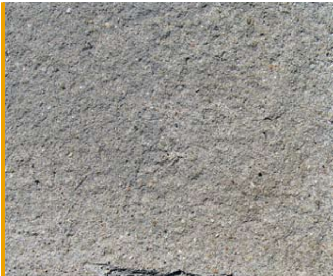
13. Brno, tereny targowe, Café-Kino, proj. Emil Králík, 1928, dawniej otwarta loggia ściany południowo-wschodniej; oryginalny porysowany tynk typu BRIZOLIT (fot. Ivo Hammer 2005)
