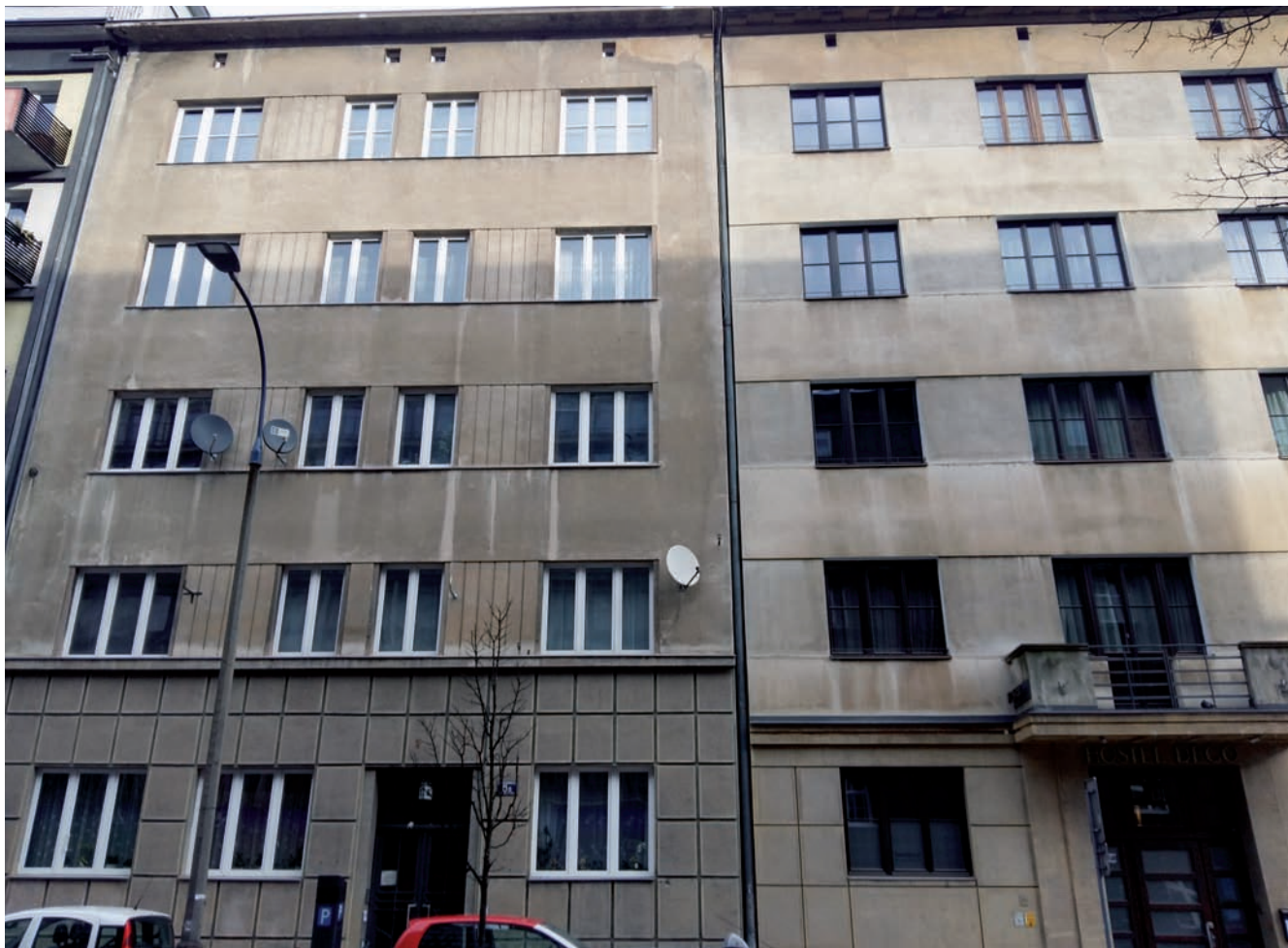
2. Z. Grünberg 1938, kamienice przy ulicy Mazowieckiej 3a, 5a. Tynki szlachetne zachowały się na obu elewacjach w zaskakująco dobrym stanie. Uwagę zwraca ich wysmakowana kolorystyka i zróżnicowanie wykończenia powierzchni. (fot. autorki, 2017)
