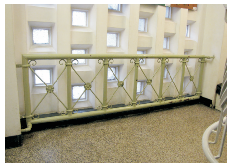
Klatka schodowa - kaloryfer rurowy
