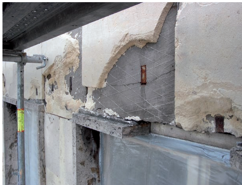
9. Fragment elewacji północnej z uszkodzoną okładziną kamienną, 2002 r. (fot. autor)
