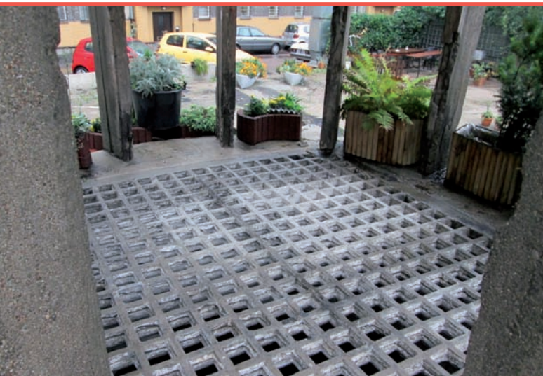
23. Posadzka w wiacie w formie szkłobetonu (obecnie brak kształtek szklanych), widok współczesny (fot. autor)
