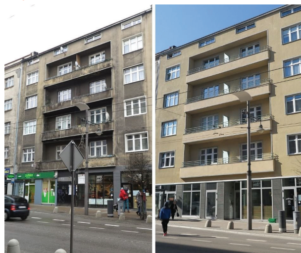
Budynek przy ul. Świętojańskiej 46: elewacja przed i po pracach konserwatorskich/fot. Biuro Miejskiego Konserwatora Zabytków
