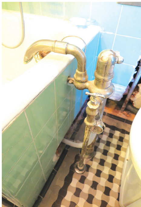
Bateria wannowa stojąca, w jednej z łazienek w budynku przy ul. 3 Maja 27-31
