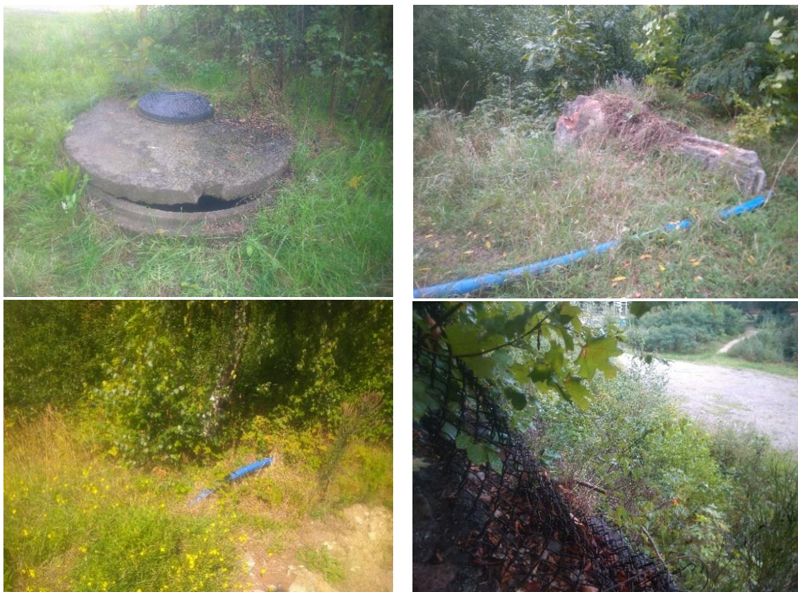
Fot. nr 178, 179, 180, 181. Niebezpieczne elementy terenu, znajdujące się na terenie po byłych basenach
