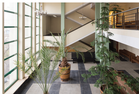
Wnętrze holu przed remontem. Filary wykończone szlachetnymi tynkami są pokryte wieloma warstwami farb, dwubarwna posadzka z lastryka nosi liczne ślady zużycia.
