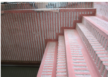
Portal kamienicy przy ul. Bema wykończony tynkami kamieniarskimi w trakcie prac konserwatorskich.
