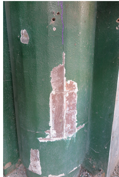
Szczegół filaru flankującego wejście do budynku – spod warstwy zielonej farby wyłania się oryginalne wykończenie brązowymi kształtkami ceramicznymi.
