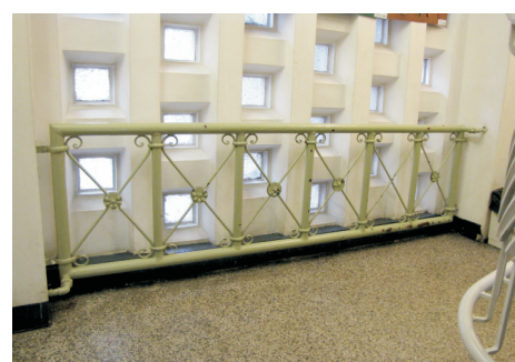
Klatka schodowa - kaloryfer rurowy
